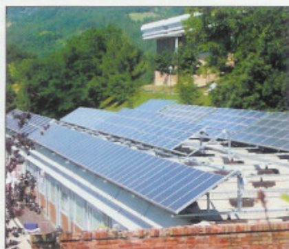
Una veduta del tetto dell'Università di Urbino, ex sede della Sogesta. L'impianto fotovoltaico viene costantemente monitorato.
